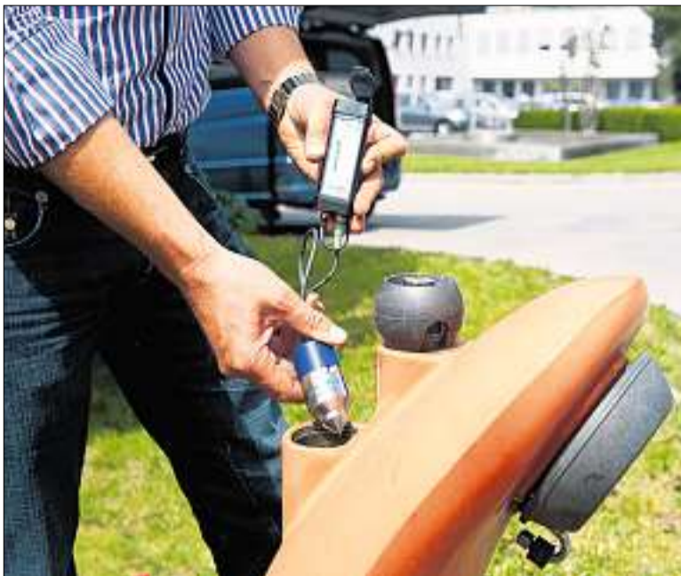
Mit diesem neuen Gerät, das jetzt in den Hydranten eingesetzt wurde, spart die Stadt 45 Millionen Liter Wasser. (Foto Olivia Item)
