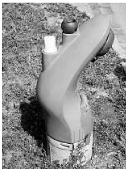
Jeder Hydrant überwacht: Das neue Leckortungssystem (weisse Kappe) hilft Wasser sparen.
